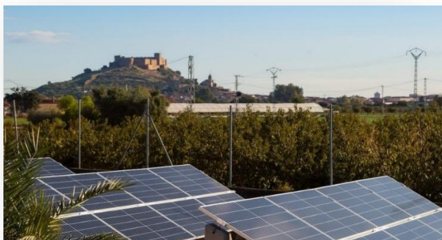
Imagen 14. Instalación Fotovoltaica para autoconsumo
