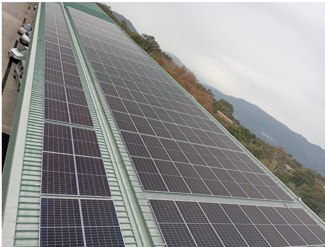
Imagen 8 – Placas solares instaladas. Fte.: CEL Salto del Calderón.
