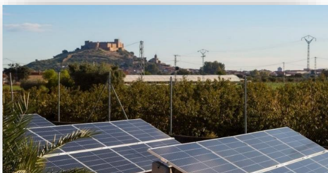
Imagem 14. Instalação fotovoltaica para autoconsumo
