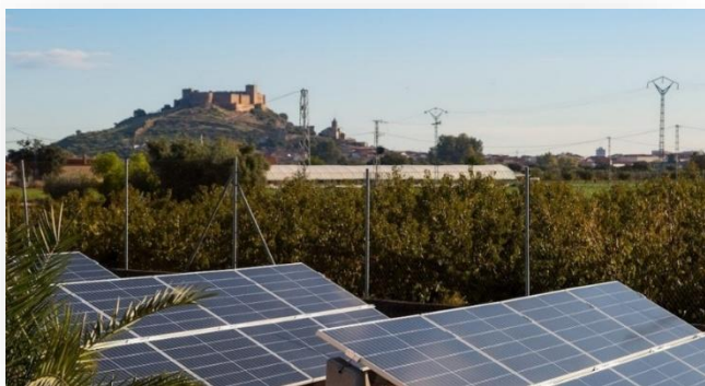
Imagen 14. Instalación Fotovoltaica para autoconsumo
